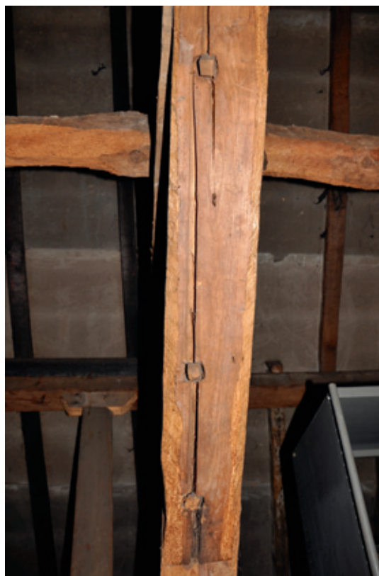
Fig. 17. Ferme IV. Détail de l'aiselier assemblé à l'arbalétrier et au faux-entrait par trois chevilles passantes. © cliché Paulo Charruadas & Philippe Sosnowska, 2010
