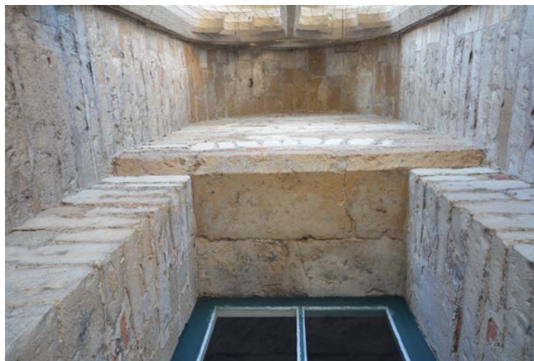
Fig. 11 – Tour, élévation nord, quatrième étage, vue du double linteau et de la maçonnerie haute (S. Byl, F. Huyvaert © ULB - VdB).
