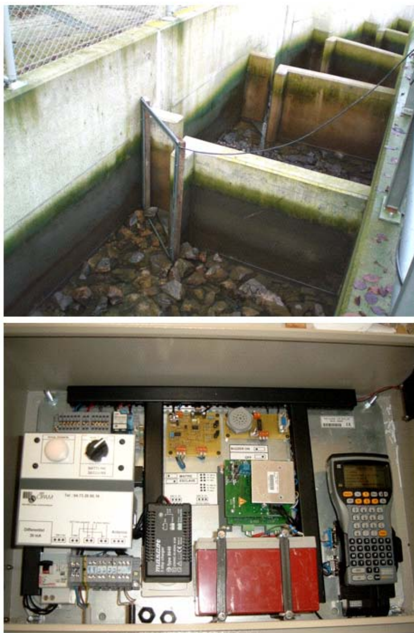
Figure 3 : En haut : vue d'une antenne de détection CIPAM placée dans un bassin d'une échelle à poissons, en l'occurrence l'échelle à poissons du barrage de Lorcé sur l'Amblève . En bas : boîtier électronique de détection CIPAM à placer dans le local de visualisation de l'échelle à poissons du barrage de Monsin (étude LDPH UILg pour SPW-DCENN).
