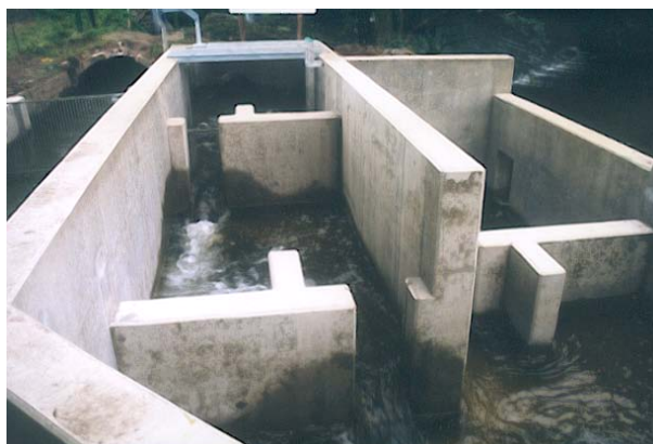
Figure 9. Vue de l'échelle à poissons du barrage de Berneau sur la Berwinne (mise en service en 2002)
