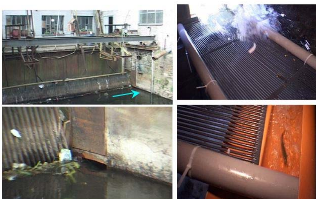
Figure 1. Vues (à gauche) de l'exutoire de dévalaison latéral aménagé dans le prolongement de la grille de la prise d'eau de la centrale hydroélectrique Merytherm (10 m 3 /s maximum) sur l'Ourthe et (à droite) du système de récupération des poissons.
