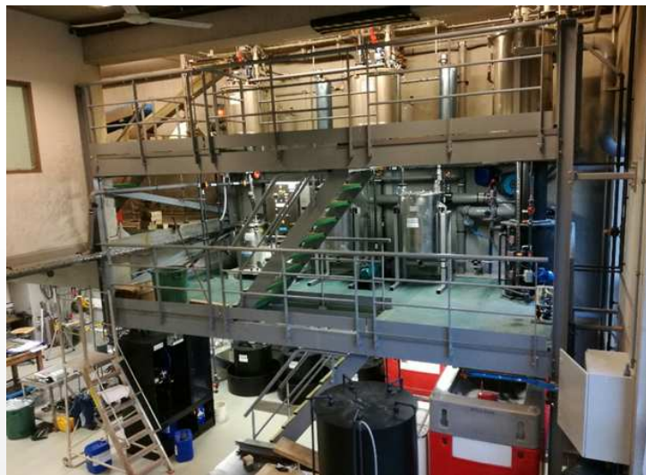
Installation pilote d'hydrométallurgie @ULiege
