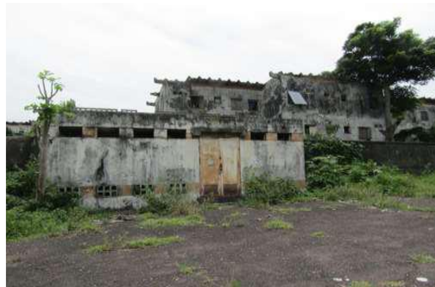
Figure 18 : L'état de délabrement des maisons en 2019
