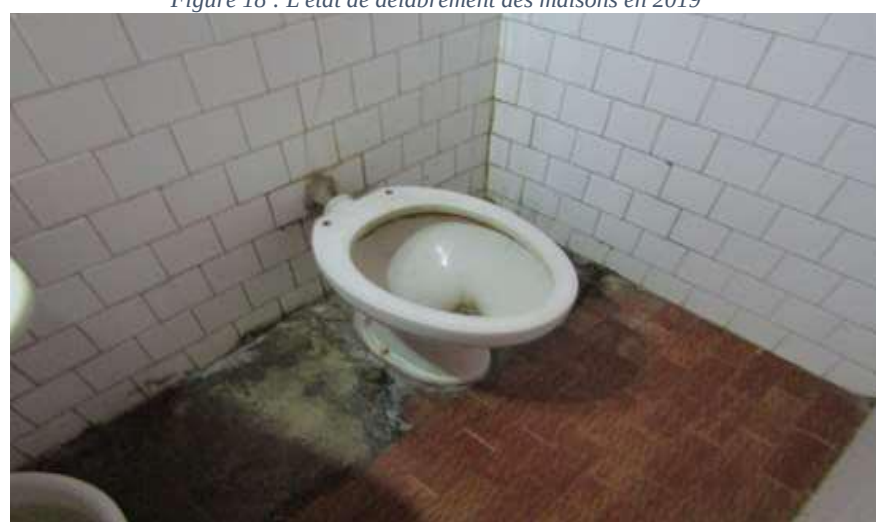
Figure 19 : L'état des toilettes au camp Mangengenge en 2019
