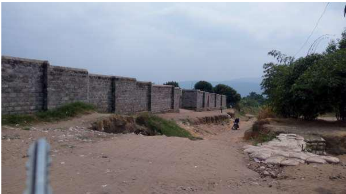
Figure 25 : Une érosion menaçant la clôture du Complexe scolaire Nzamu
