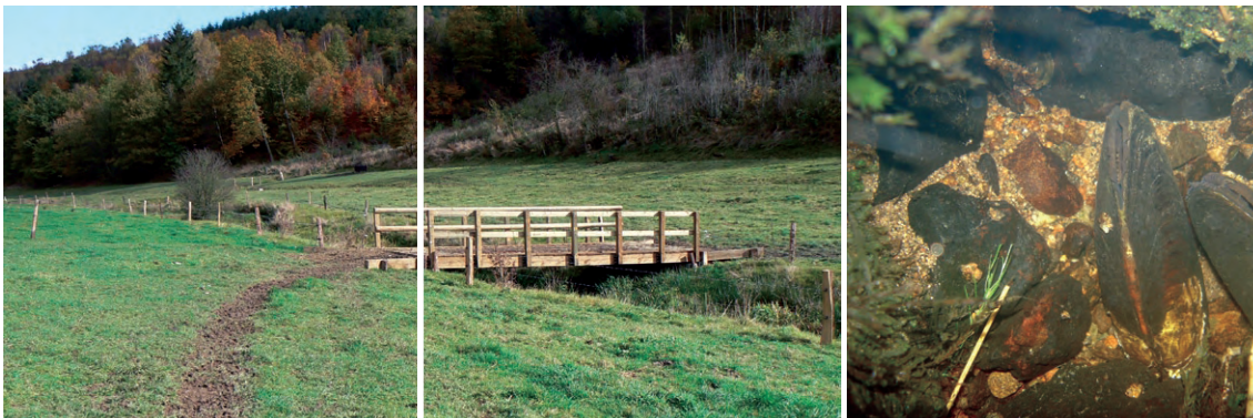
Construction d'une passerelle en bois au dessus d'un ruisseau pour le passage du bétail
