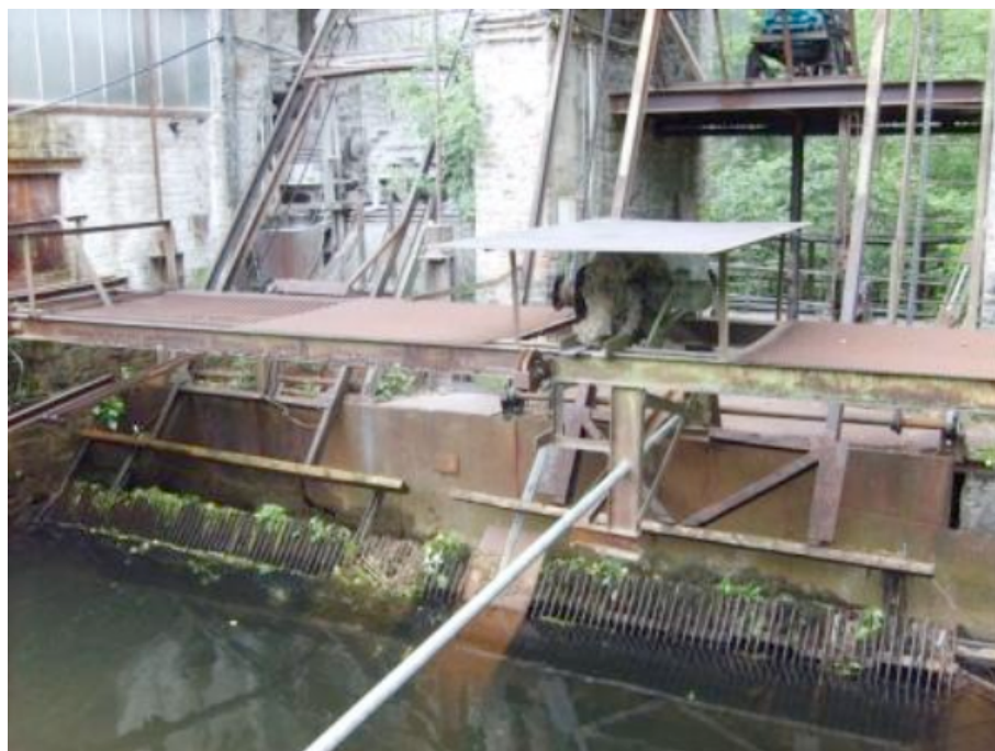
Figure 3/4. Grille sur la prise d'eau de la microcentrale hydro-électrique (7m 3 /s) associée au seuil de Raborive. Photo Contrat de Rivière Amblève.
