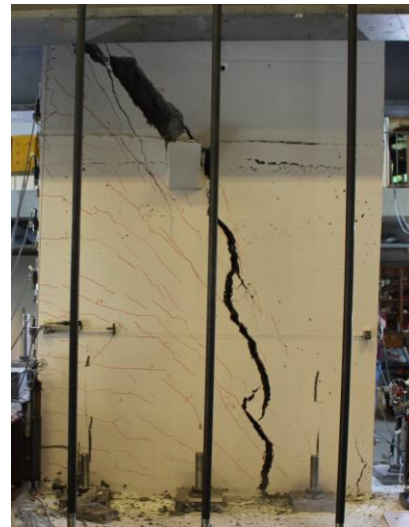
Fig. 15 Rupture du voile 4
