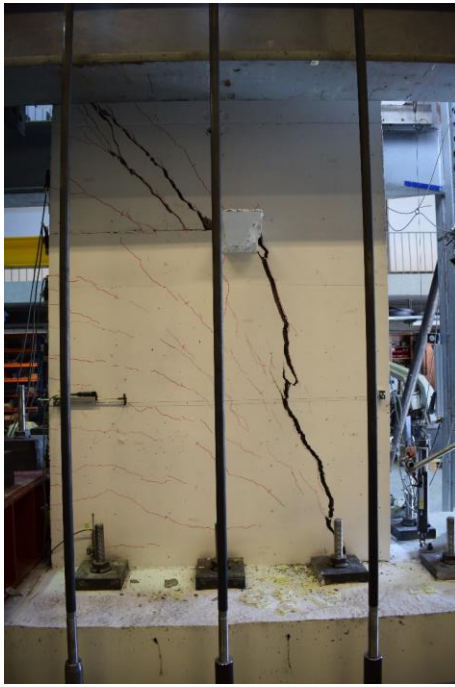
Fig. 12 Rupture du voile 2
