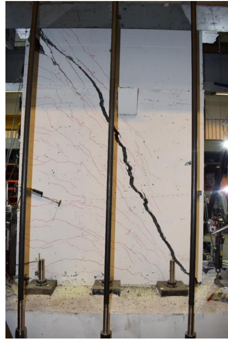
Fig. 13 Rupture du voile 3
