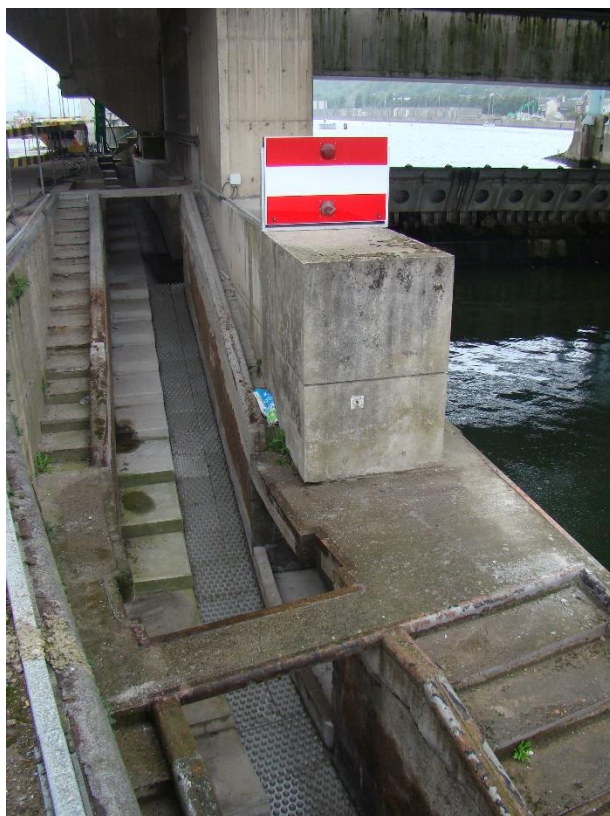
Fig.10 : Nouvelle passe à anguilles sur le barrage d'Ivoz Ramet
