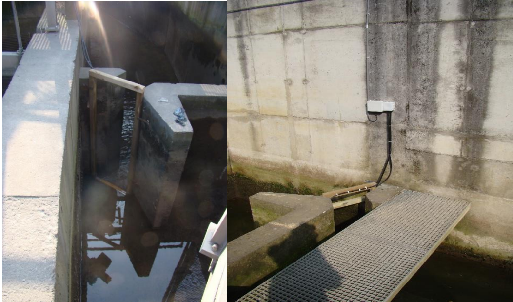
Fig. 5 : Photo de l'antenne de détection RFID placée au niveau de la dernière échancrure de la passe à poissons de Monsin (à gauche) et celle installée en 2015 dans la partie aval de l'échelle à poissons (à droite).
