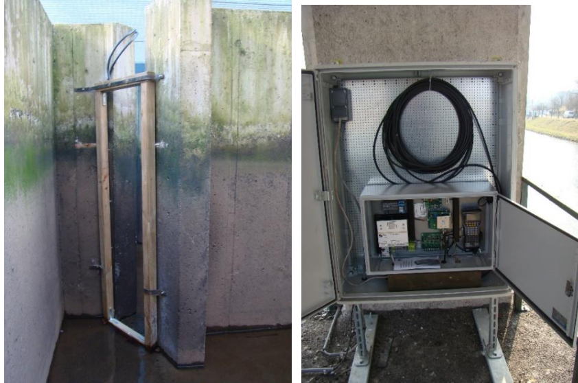
Fig.6 : A gauche : antenne de détection RFID au niveau d'une échancrure à l'amont de l'échelle à poissons du barrage des Grosses Battes sur la basse Ourthe à Liège. A droite : station d'enregistrement des données logée dans une armoire métallique spécialement installée sur la pile du barrage mobile.
