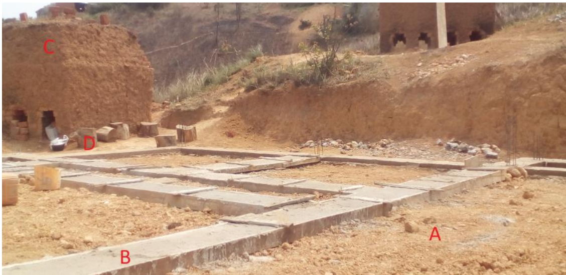
Fig. 100. Exemple de construction. A. parcelle à construire : il s'agit de la zone d'où a été extraite la terre pour faire les briques. B. Fondation de la nouvelle maison faite de pierre et de sable de la région et du ciment produit dans la province. C. Four traditionnel pour cuire les briques. Ce four utilise le bois comme combustible. D. Bois de combustion.
