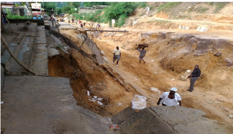
PHOTO II,2,VII,3 : ROUTE DE KIMWENZA AVANT L'ÉROSION
