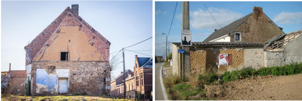
Fig. 17. Mur intérieur d'habitation du XIXème siècle à Estinnes (à gauche) et Remise à Wasseiges (à droite) en adobes (Pereira-Goncalves, 2017).
