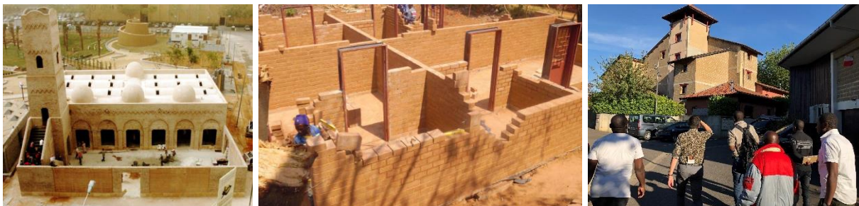
Fig. 6. Quelques réalisations en BTC. De gauche à droite : la Mosquée Al Medy à Ryad en Arabie Saoudite ; un chantier en BTC à Lubumbashi en R.D. Congo ; une maison en BTC à L'Isle-d'Abeau en France (Anger et Fontaine, 2009 ; Caritas Lubumbashi, 2011).
