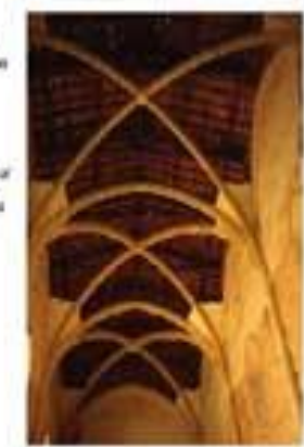
Prise à l'occasion de la restauration de la nef*, cette photographie montre les nervures de pierre qui supportent la voûte en arc-bouté d'ogives.
