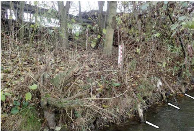
Fig. 5 – Berwinne à Berneau (ID-4a) : berge stabilisée, fascine détruite et légère reprise d'érosion du pied de berge 16 ans après les travaux. Les flèches blanches montrent les piquets de l'ancienne fascine.
