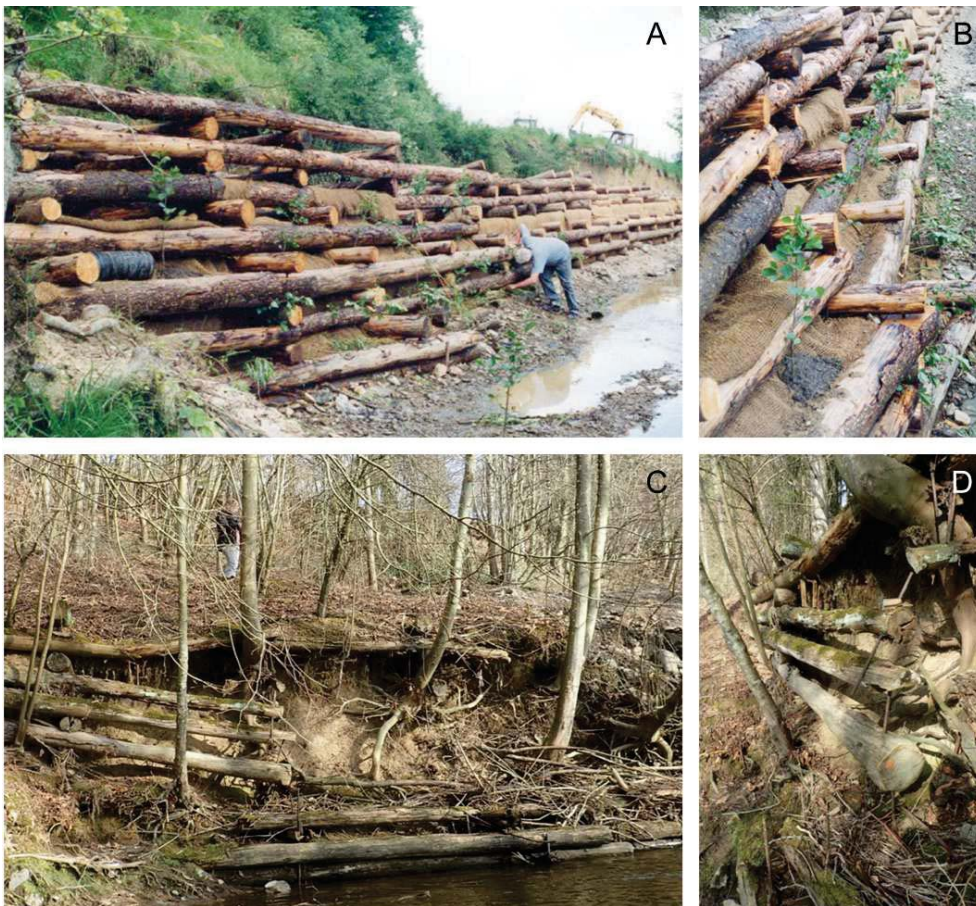
Fig. 8 – Caisson sur l’Eau Noire à Petigny (ID-10).
