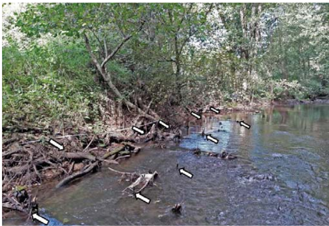
Fig. 6 – Aisne à Juzaine (ID-2b) : peigne détruit 15 ans après sa mise en place et berge en cours d'érosion.
