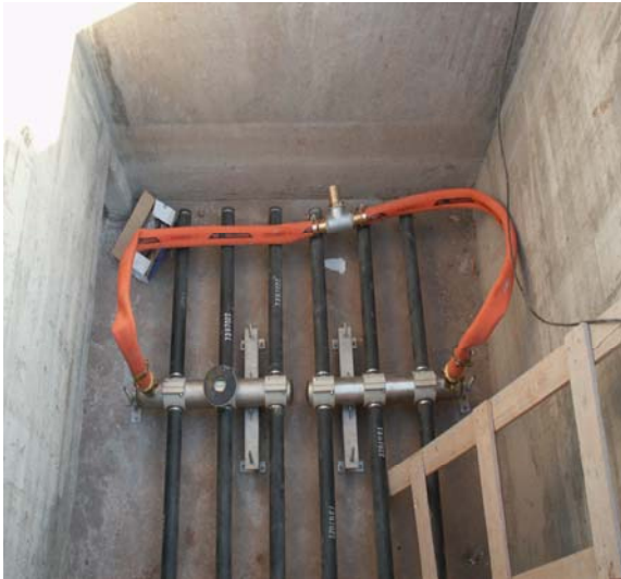
Photo 5. Raccordement des raquettes de diffuseurs
