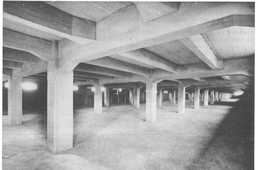
LE BÉTON ET SA SIMPLE VÉRITÉ | LES MAGASINS DU COMPTOIR GÉNÉRAL D'APPROVISIONNEMENT, A WASMUEL. EXECUTION DE LA S.A. DE TRAVAUX TIRIFAHY, A CHARLEROI.
