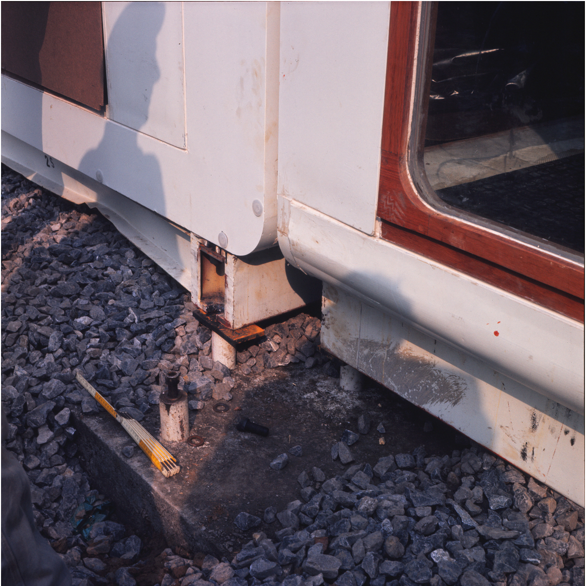
Fig. 85 : positionnement orthogonal de deux VM et plot métallique de fondation en attente. On remarquera que le châssis de gauche a été maltraité lors de sa manutention.
