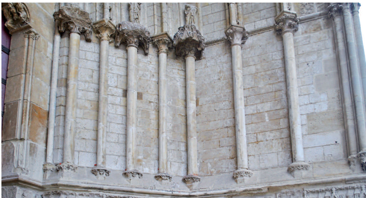
FIG. 45. — Portail méridional de la collégiale Notre-Dame. Vue d'ensemble de l'ébrasement de droite avec ses colonnettes et leurs dais et chapiteaux. © L. Nys.
