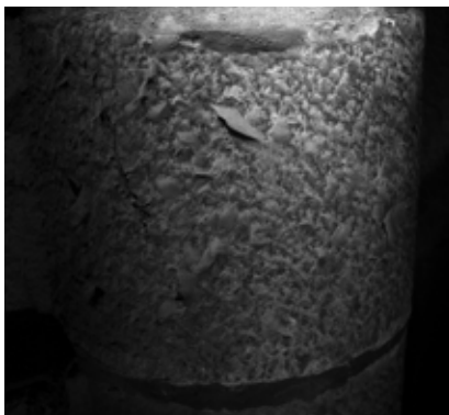
Fig. 29.- Taille à la broche sur le noyau d'une des marches du premier groupe de l'escalier nord.
