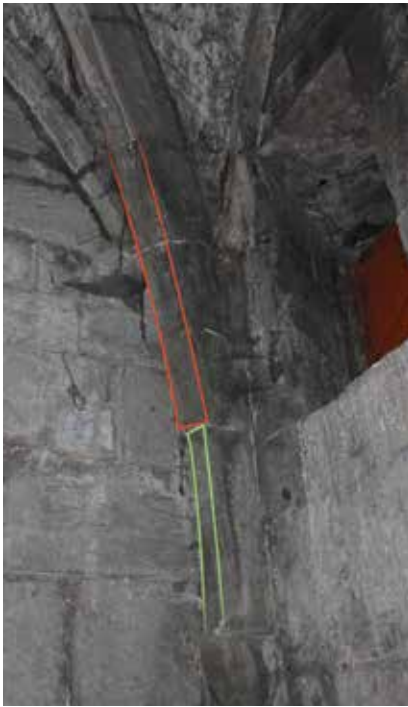
Fig. 18.- Raccord défectueux dans la voûte du deuxième étage de la tour sud. © Antoine Baudry, 2014 (infographie : Guillaume Magermans).
