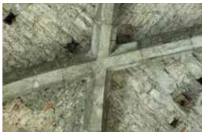
Fig. 10.- Clé de voûte au deuxième étage de la tour sud. © Antoine Baudry, 2014.
