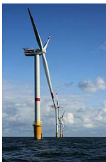
Fig. 5 : éoliennes sur le Parc éolien de Thorntonbank (28 km des côtes belges en mer du Nord) ; la partie émergée mesure 157 m de haut, soit 184 m au-dessus du fond marin ; le diamètre balayé est de 126 m, chaque pale mesurant 61,5 m ; puissance de 5 MW par turbine « REpower » (extrait de Wikipédia).
