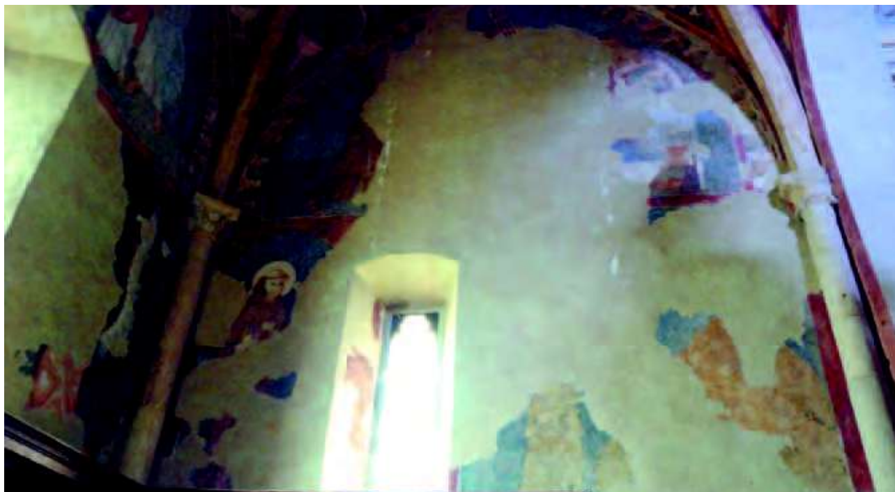
Castelvecchio Subequo (AQ), San Francesco, interno, coro, parete destra dopo il sisma prima dell'intervento di messa in sicurezza, Archivio DiSMM, Vettori, 2009.
