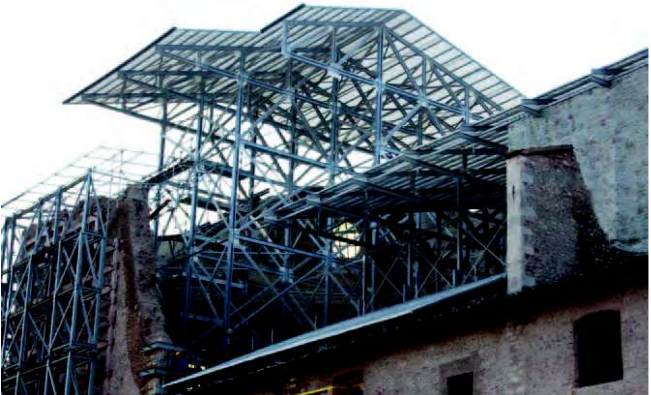
L'Aquila, Santa Maria di Paganica, esterno, lato settentrionale, cupola crollata, fase di montaggio della copertura provvisoria, Archivio DiSMM, Fantone, 2011.
