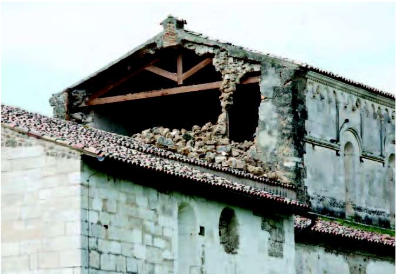
Castiglione a Casauria (PE), San Clemente a Casauria, esterno, lato nord-orientale, timpano crollato in conseguenza del sisma, Lattanzi, www.inabruzzo.it , 2009.
