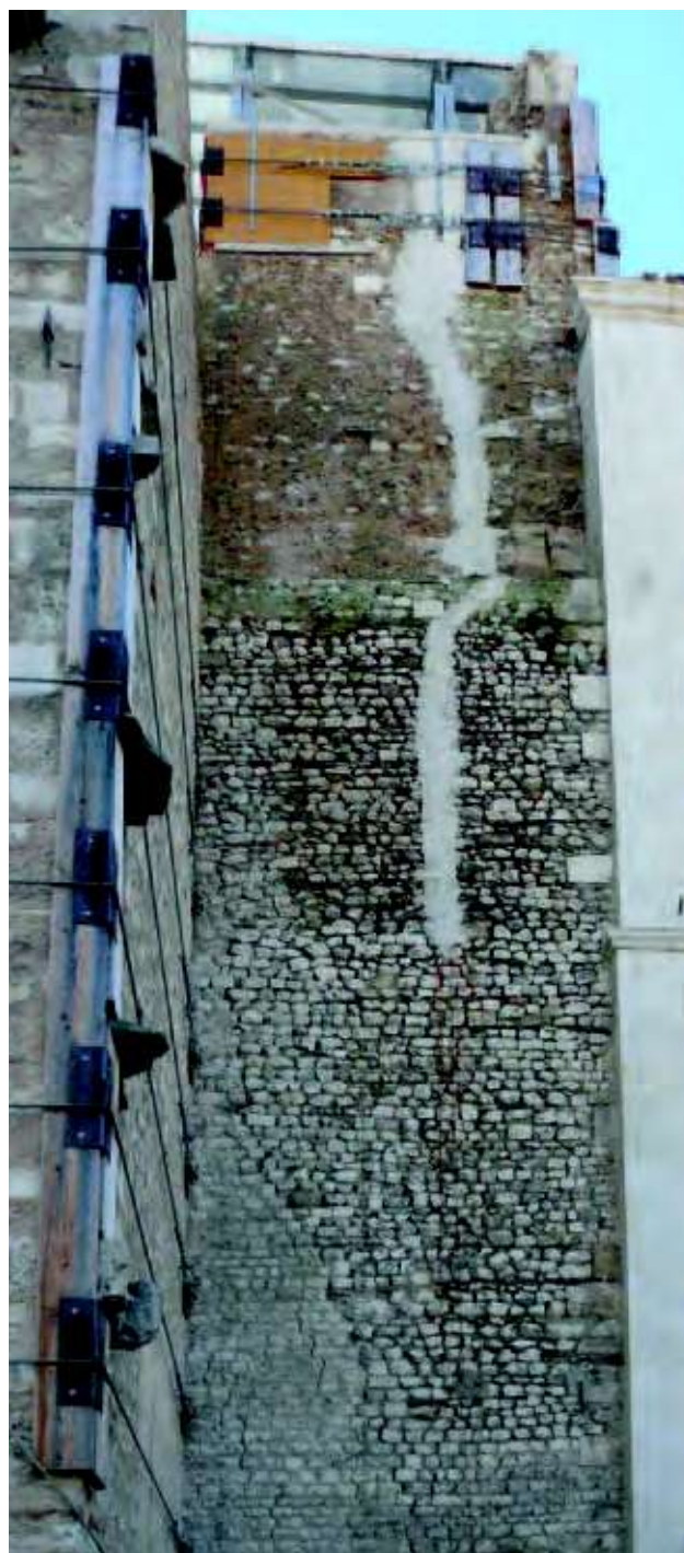
L'Aquila, Santa Maria di Paganica, esterno, lato settentrionale, parete angolare in prossimità della facciata, Archivio DiSMM, 2010.
