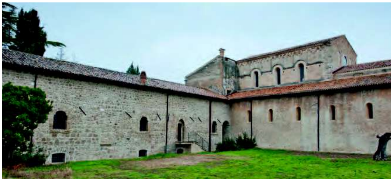
Castiglione a Casauria (PE), San Clemente a Casauria, esterno, lato sud-orientale, dopo l'intervento di risarcimento, Archivio DiSMM, 2011.
