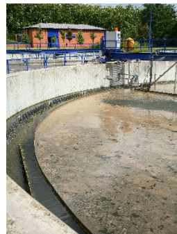
Séparation de l'eau épurée et de la boue Décanteur
