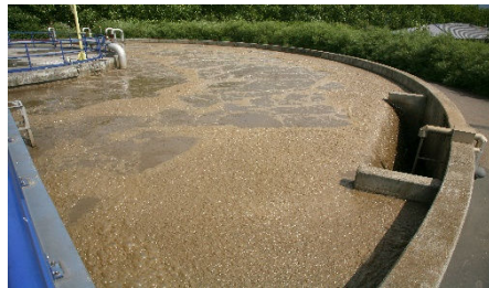
Traitement biologique Bassin à boues activées
