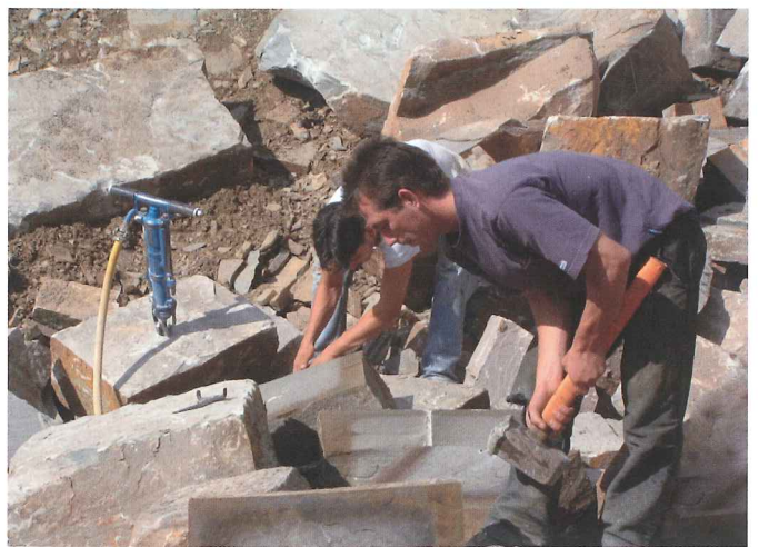
Fig. 21 – Débitage artisanal (marteau perforateur et masse) de blocs de grès famenniens à la carrière de Triffoy, lorsque celle-ci était en pleine activité (photo E. Goemaere, 2004).
