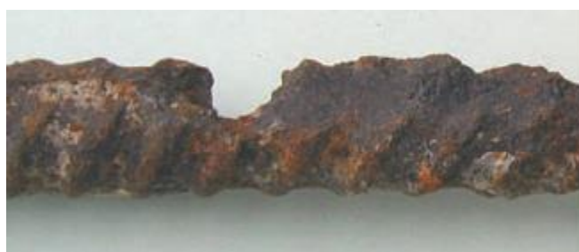
Figure 6-56 – Dégradation d'une armature : piqûres de corrosion dues aux chlorures
