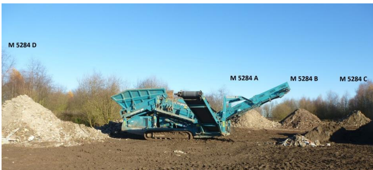
Photo 1 : Vue des quatre tas de déchets bruts et de l'unité mobile de prétraitement.
