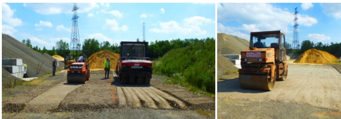
Figure 127 : Compactage de la seconde planche d'essai (a) compactage simultané avec le petit compacteur à rouleaux et le compacteur à pneus ; (b) Compactage complémentaire avec le gros compacteur à rouleaux.
