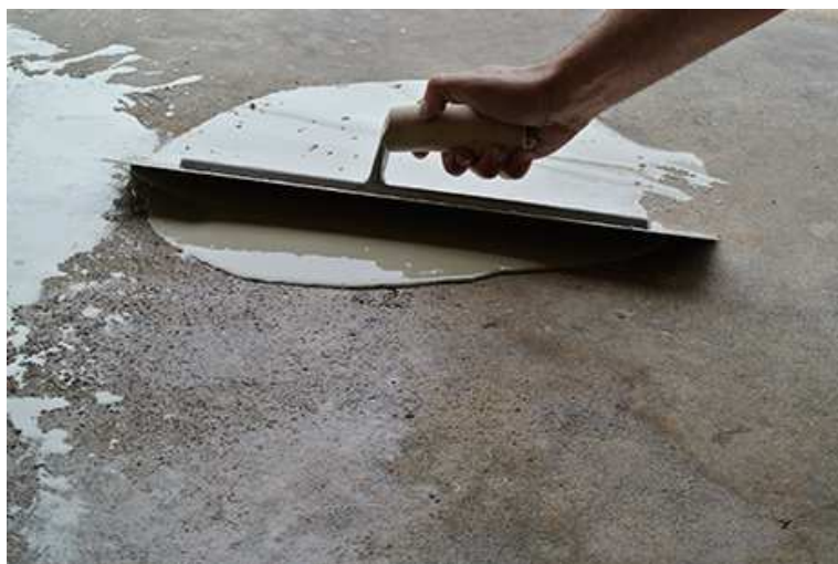
Figure 15 – Resurfacement d'éléments en béton (dalle de sol) [ http://www.cimentme.com ].
