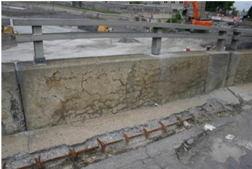
Figure 22 – Dégradations typiques due à l'alcali-réaction dans le béton.
