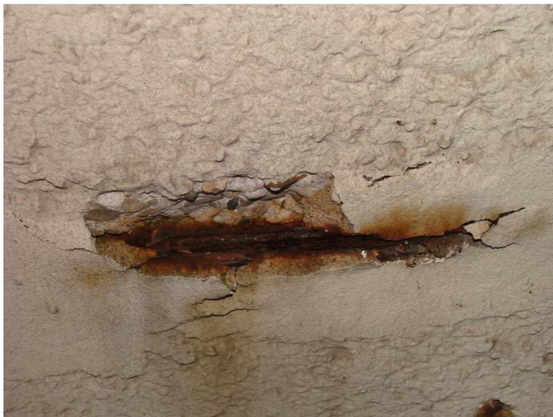
Figure 18 – Dégradation liée à l'effet des ions chlores.
