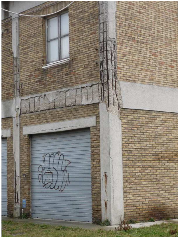
Figure 17 – Dégradation liée à la carbonatation des bétons.
