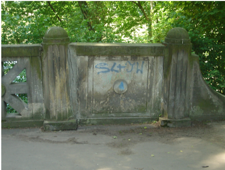
Figure 24 – Fissuration après réparation ( Parc Skaryszewski, Varsovie ).
