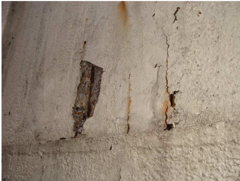
Figure 12 – Effets de la corrosion des armatures.
