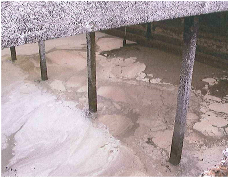
Figure 20 – Désintégration du béton par attaque sulfatique dans un bassin de stockage d'eaux usées.
