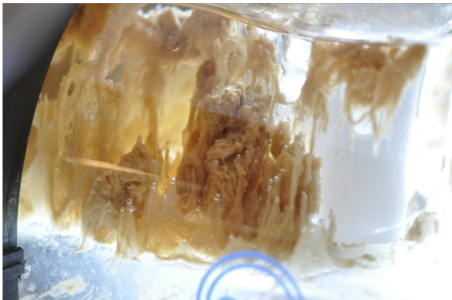
Abbildung 6.33: Mulm im Ablaufbereich des Abscheiders im technischen System 1
