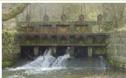
Photo 1: Vannage de Gemenne
