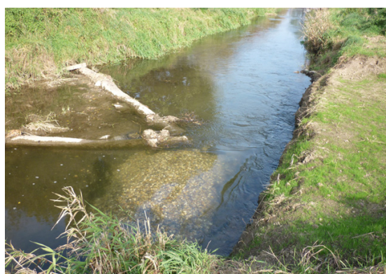
Photo 6: Défecteur en troncs en rive gauche, déblai de la berge droite et frayère reconstituée (vue vers l'aval)
