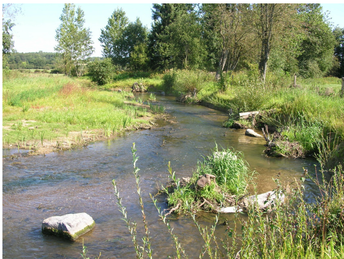
Photo 7: Diversification des habitats dans le méandre (vue vers l'aval, 10 mois après les travaux)
