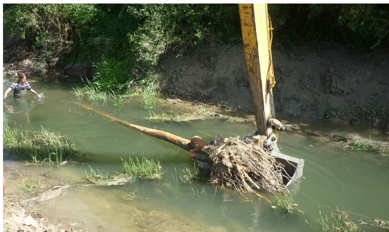
Photo 10: Pose à la pelle mécanique d'un tronc d'aulne de 6 m pourvu de sa souche (vue vers l'aval)
