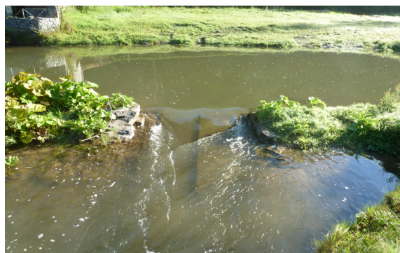
Photo 6: Large échancrure dans le déversoir
