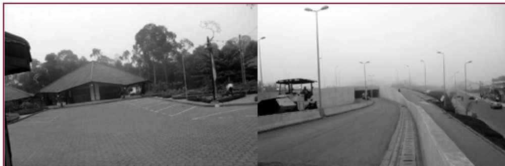
Figure 21.1. Reconstruction et embellissement de la ville de Yaoundé. La photo de droite présente la construction d'un échangeur tandis que celle de gauche montre l'aménagement d'un lieu touristique urbain, à savoir le Bois Saint Anastasie. Photos : Hélène Marigoh Bouquet.
