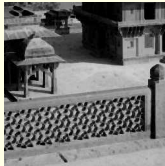
(b) Érosion par un carré
