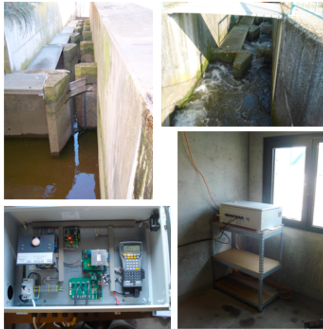
Figure 60. Détecteur RFID de poissons pucés installé en 2011 dans la passe à bassins du barrage d'Yvoz-Ramet sur la Meuse (km 97,1). Au-dessus : antenne de détection placée sur la fente du bassin supérieur à sec (à gauche) et sous eau (à droite). En-dessous : boîtier électronique (à gauche) abrité dans un local du barrage + centrale hydroélectrique (à droite).
