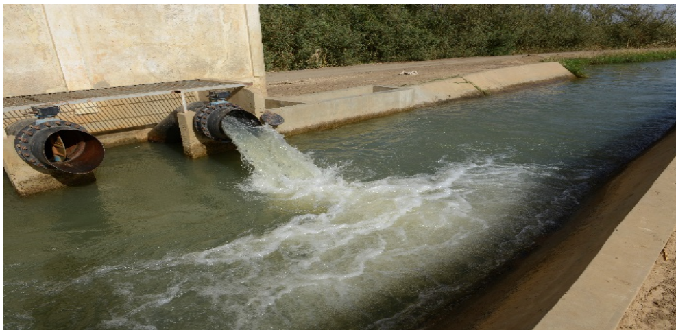
Figure IV-7 : Station de pompage de la cuvette de Ndelle et canal principal d'irrigation
