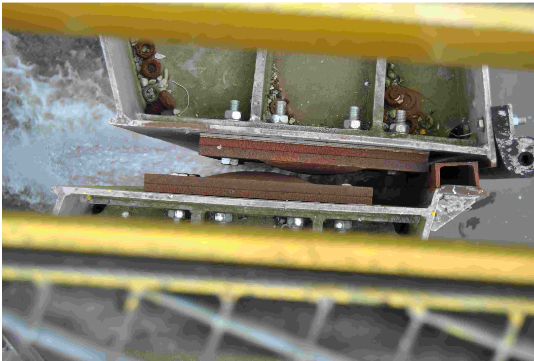
FIGURE 4.5 – Non alignement des heurtoirs du poteau busqué sur la porte aval [Vercruysse]
