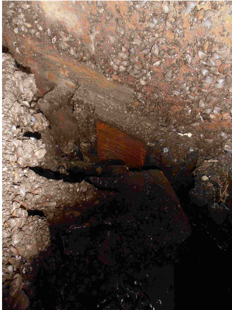
FIGURE 4.8 – Usure importante d'un heurtoir à l'amont [Vercruysse]
