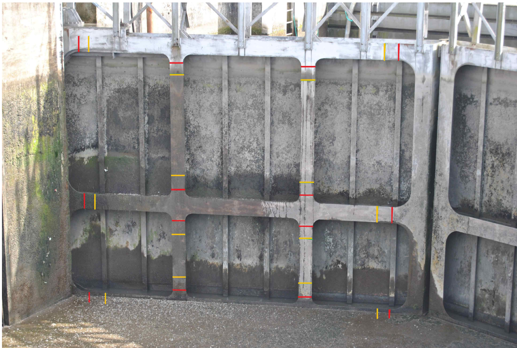
FIGURE 6.13 – Localisation des anciennes soudures (en rouge) et des nouvelles (en jaune) [Vercruysse]
