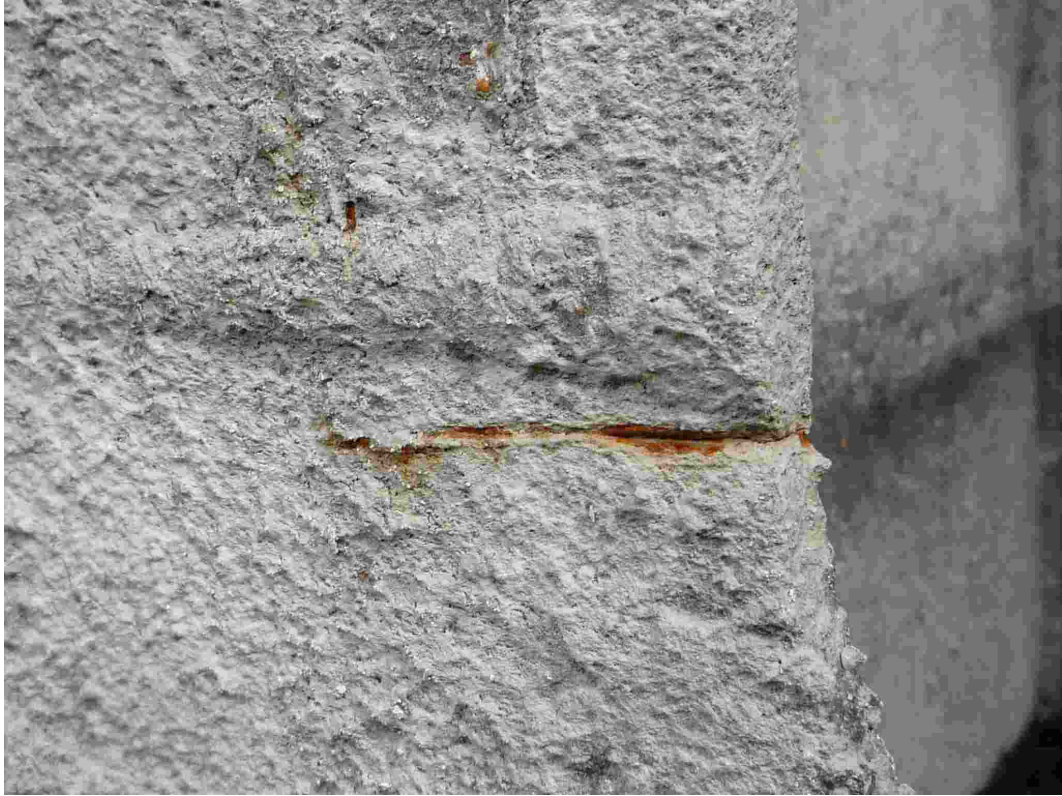
FIGURE 4.9 – Amorce de fissure sur le vantaïl gauche
