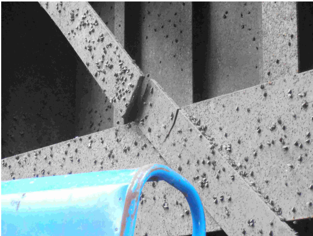
FIGURE 4.3 – Fissure dans une diagonale de la porte aval [Vercruysse]
