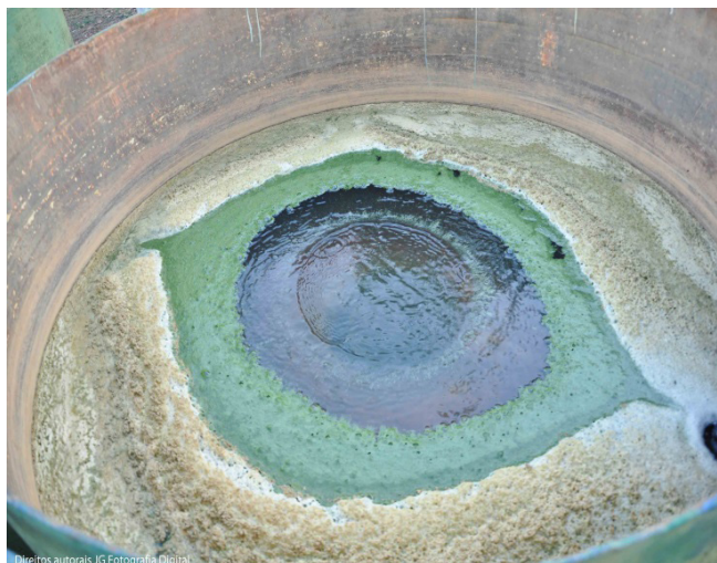
Figura 2: Floculador da estação de tratamento de água da cidade de Pedra Corrida – MG, em Setembro de 2012. Foto de Josinei.
