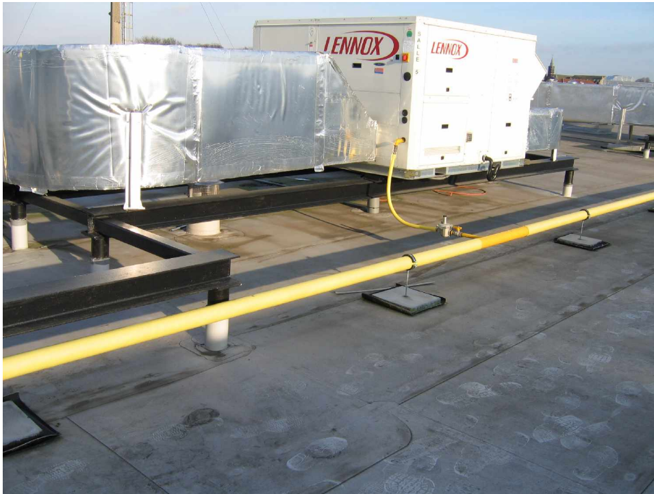
Figure 16 : Surélévation des appareillages [Auteur : Degré A., 2006].
