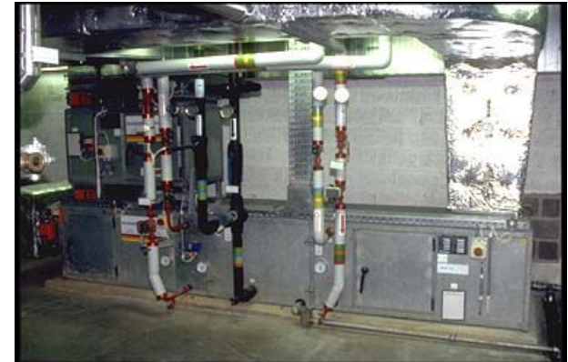
Système de traitement d'air
