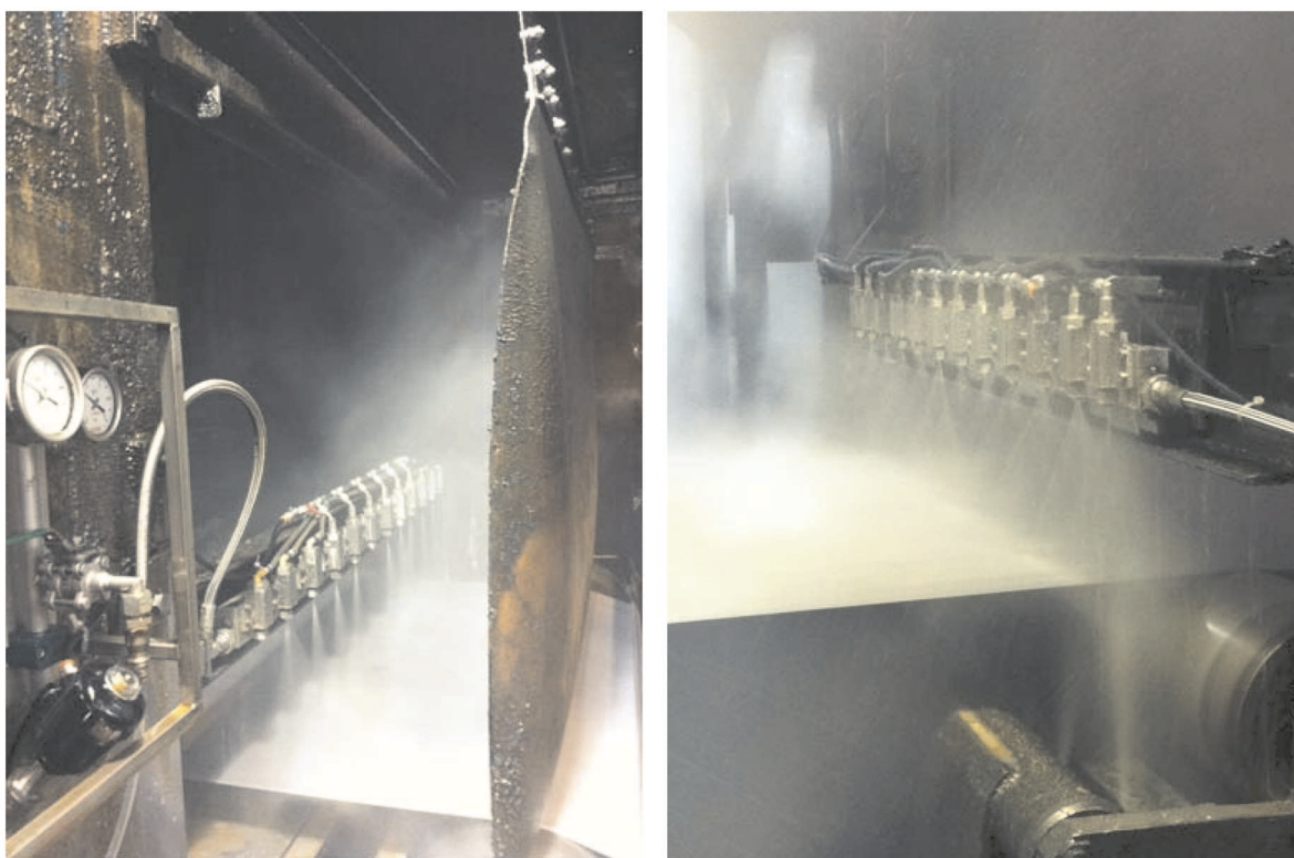
FIGURE 3.23 – Photos des rampes du système d'aspersion utilisé sur les cages 1 et 3 du laminoir 4 cages de Tilleur. À gauche : entrée de la cage 1. À droite : entrée de la cage 3.
