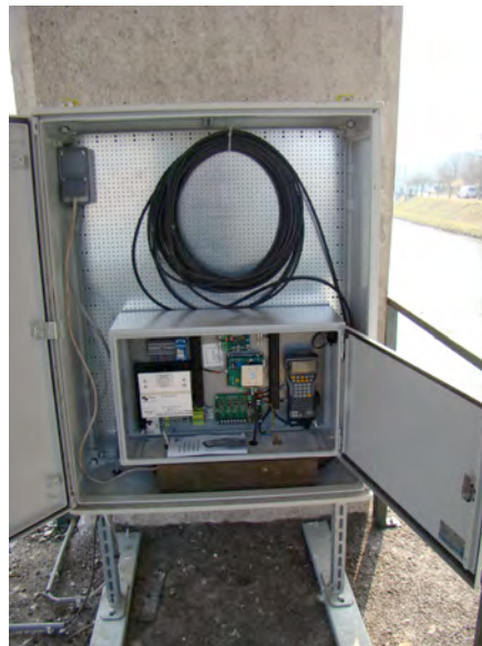
Figure 78. Au-dessus : antenne de détection CIPAM placée en 2012 au niveau d'une échancrure à l'amont de l'échelle à poissons du barrage des Grosses Battes sur la basse Ourthe à Liège. En dessous : station d'enregistrement des données logée dans une armoire métallique spécialement installée sur la pile du barrage mobile.
