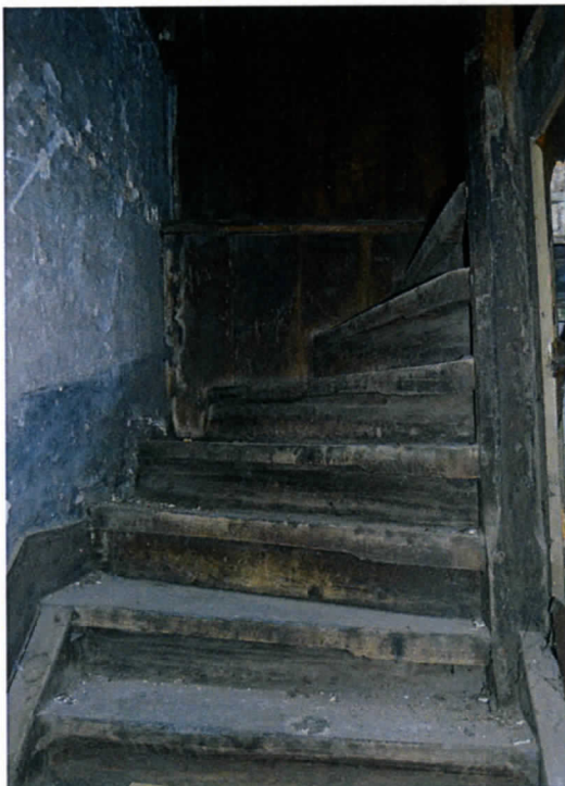
Fig.3 : Exemple d'aménagement intérieur pouvant être intégré à l'étude d'un bâtiment. Escalier menant aux combles, Maison, rue du Marché-aux-Herbes 8-10, Bruxelles © Weitz A., ULg-IRPA.
