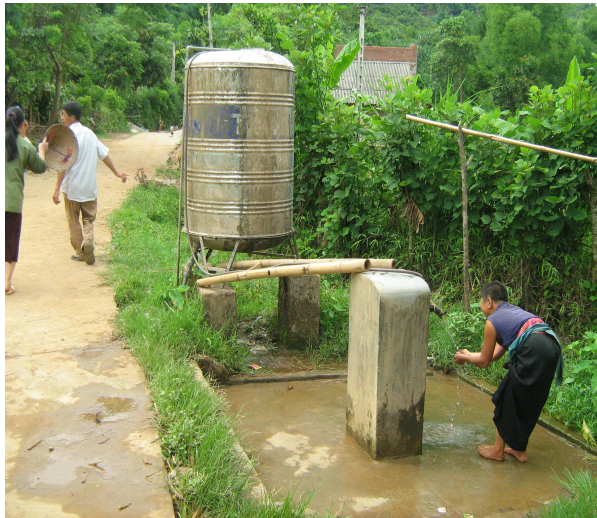
Puits public protégé dans la commune de Xuan Phong
