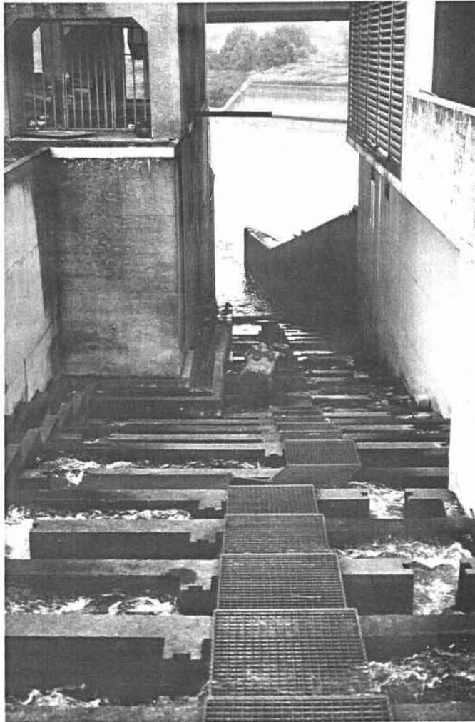
Photo 3. Vue, à partir de l'amont, de la passe migratoire du barrage de Visé-Lixhe sur la Meuse belge.
