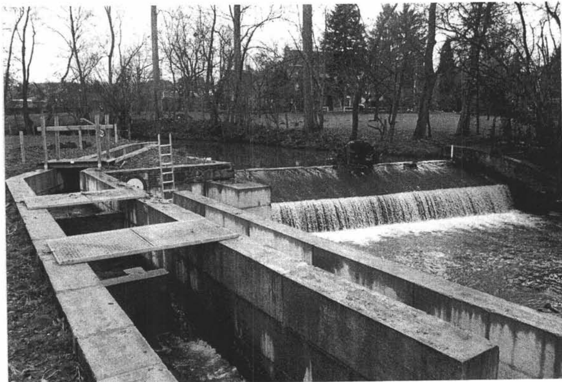
Photo 2/7. Vue de la nouvelle échelle à poissons construite en 2004 au barrage de Mortroux sur la la Berwinne.
