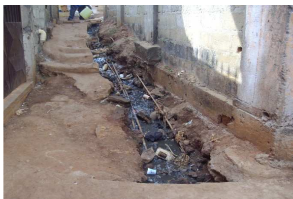
Fig. 93 : Tuyaux d'eau immergés dans des eaux usées à la Carrière
