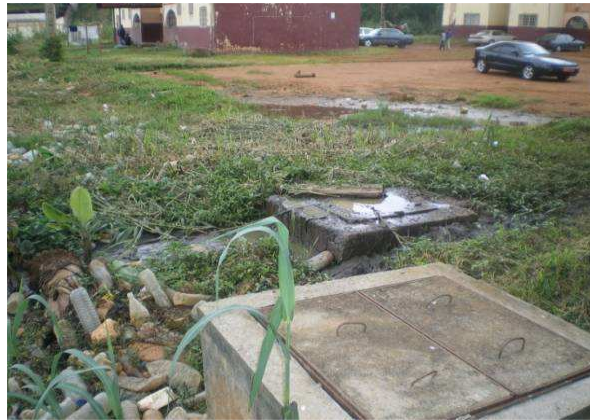
Fig. 106 : Débordement des fosses sceptiques à la Cité-verte
