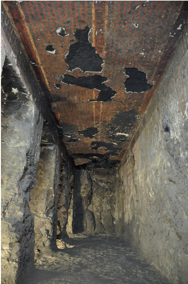
Fig. 17. TT 29, vue d'ensemble de l'aile nord-est de la salle transversale montrant le mauvais état de conservation des peintures murales. Sur la paroi droite figure le texte des « Devoirs du vizir ».
