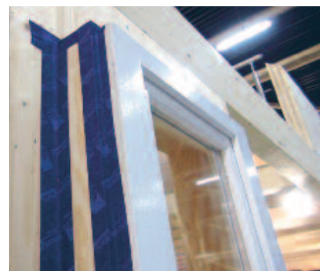
Afin d'avoir une étanchéité à l'air performante, une attention particulière doit être portée à l'isolation des châssis.
