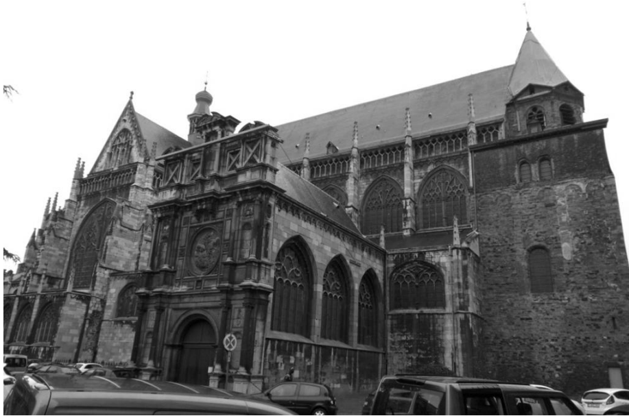
La façade nord, du côté de la place Saint-Jacques. On voit que le clocheton surmontant la partie romane et le portail Renaissance sont en mauvais état.
