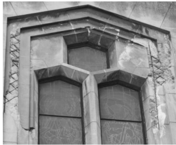
Figure 4: épaufrure autour de la baie Nord-Ouest du chœur, église Saint-Vincent, Liège (Courard et al. , 2012)
