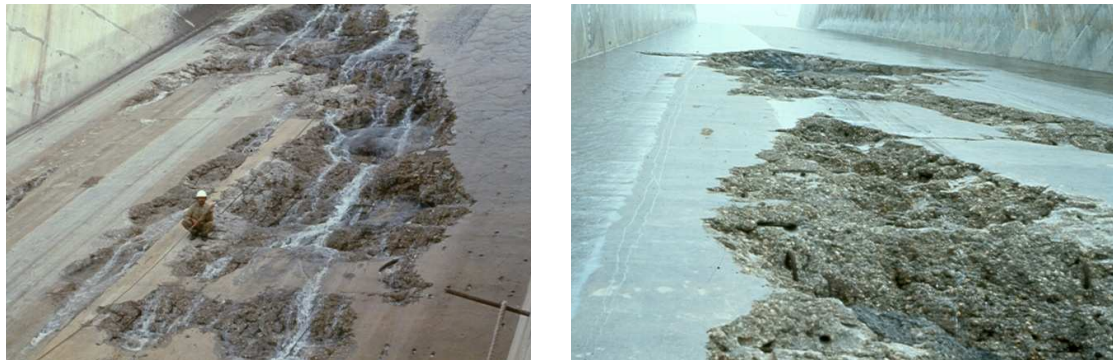
Figure 9 : photos illustrant des dégâts dus à la cavitation sur des coursiers lisses – (banque de photos du HECE).
