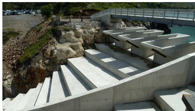
Figure 14 : photo supérieure : barrage de Goulours en France (premier déversoir en touches de piano) - (banque de photos de EDF-CIH). / photo inférieure : barrage des Gloriettes en France (déversoir en touches de piano et coursier en marches d'escalier) - (legrosjerome.free.fr, 2012).
