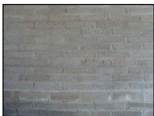
Fig 181 – « Ce sont des blocs de béton brut, il n'ont même pas eu assez d'argent pour plafonner ». [Institut Montéfiore, Jean Maquet, photo de l'auteur, 2008]
